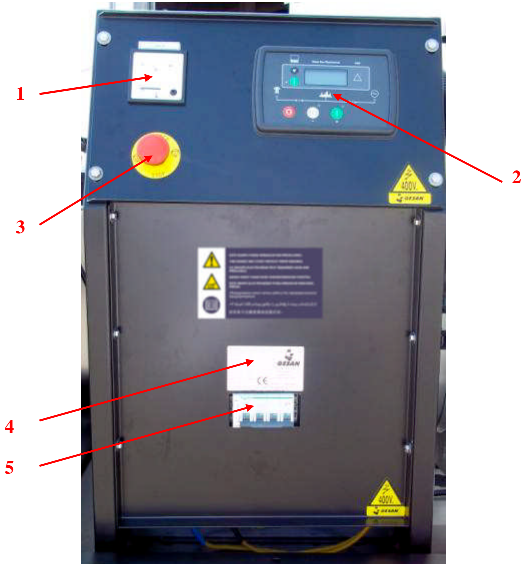
Abbildung 4- Schalt- und Versorgungskasten mit dem Steuermodul DEEP SEA
